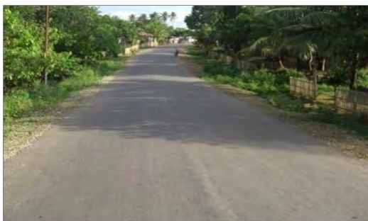
Gambar 25. Kondisi jalan dengan teknologi LPMA setelah 3 tahun pemakaian.
